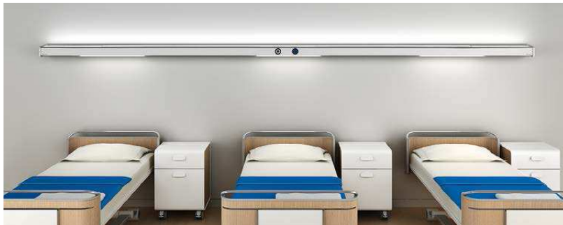
Bild 3: Dreibettzimmer mit durchgängigem LED-Lichtband (Raumlicht) und LED-Lichtmodulen (Lese-/Untersuchungslicht).
